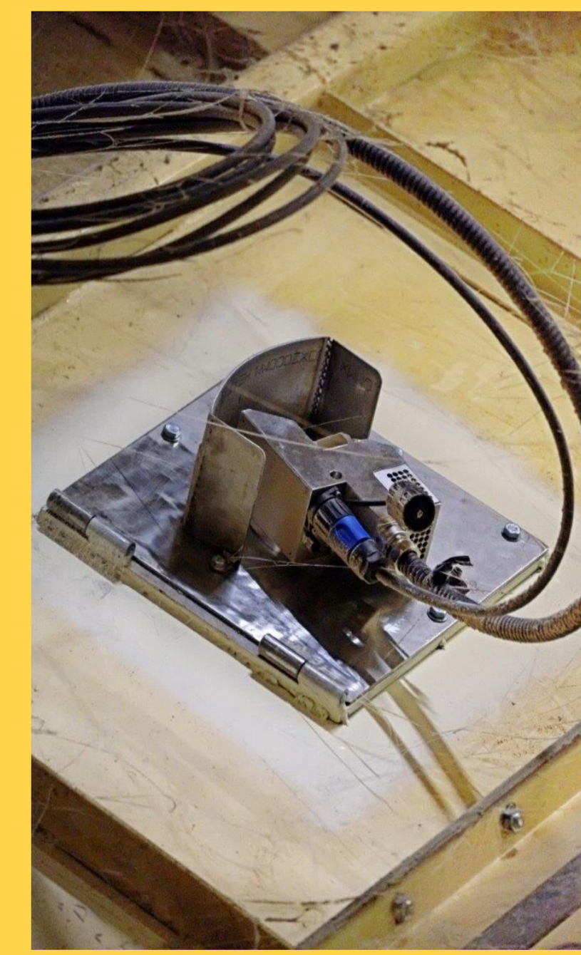
Tête d'analyse installée dans la chaîne de fabrication
